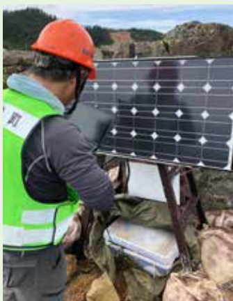
本白根山観測点。太陽光発電により駆動しています。
